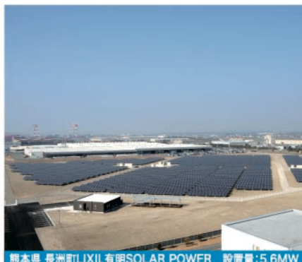
熊本県 長洲町LIXIL有明SOLAR POWER 設置量:5.6MW
