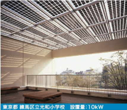
東京都 練馬区立光和小学校 設置量:10kW
