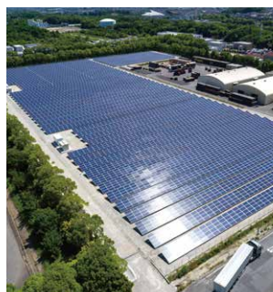
■ LIXIL知多SOLAR POWER
