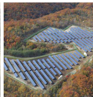
■ 苫小牧太陽光発電所
