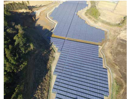
■ 香取太陽光発電所
