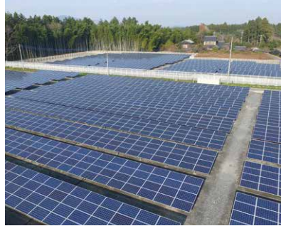
■ 笠間太陽光発電所
