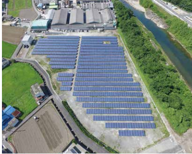
■ 市川太陽光発電所
