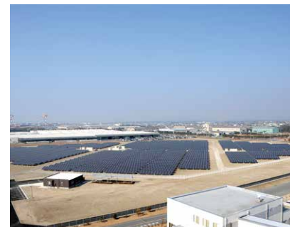
■ LIXIL有明SOLAR POWER
